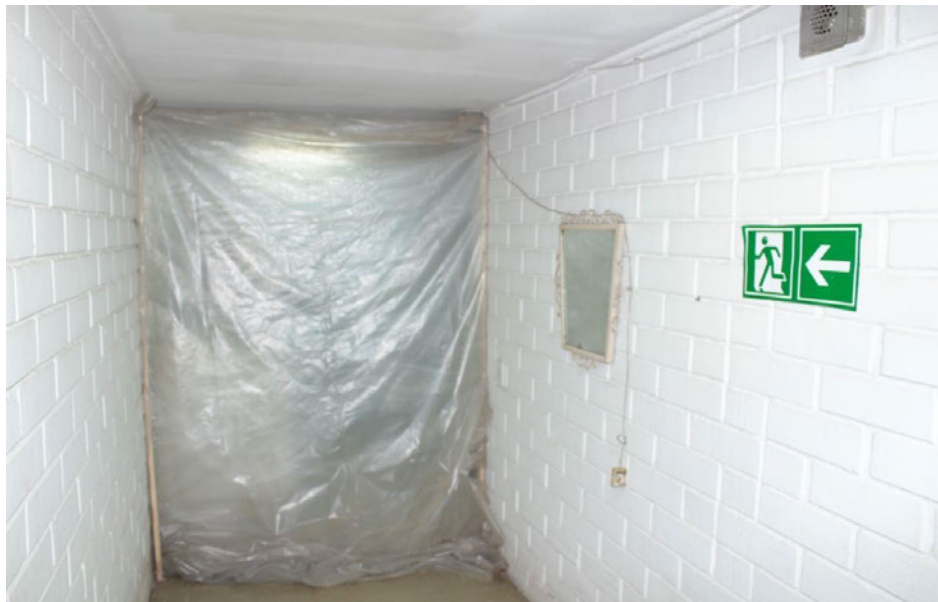
Fotografía N° 10 (vía de evacuación bloqueada con nylon)
