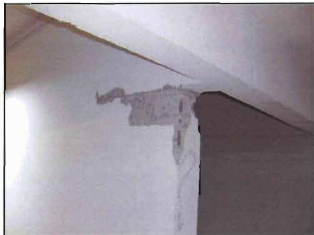
Desprendimiento de recubrimiento Falla incipiente de compresión en el muro
