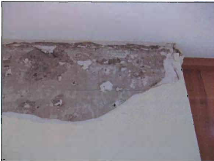
Fisura a lo largo de la intersección muro-losa.
